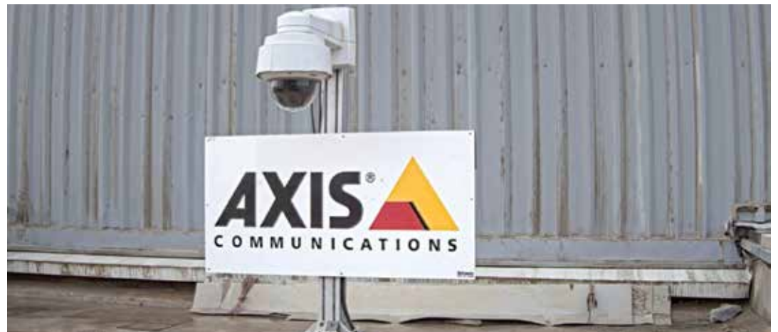
Figura 7: Cámara de prueba de Axis instalada en un entorno real en Dubái.
