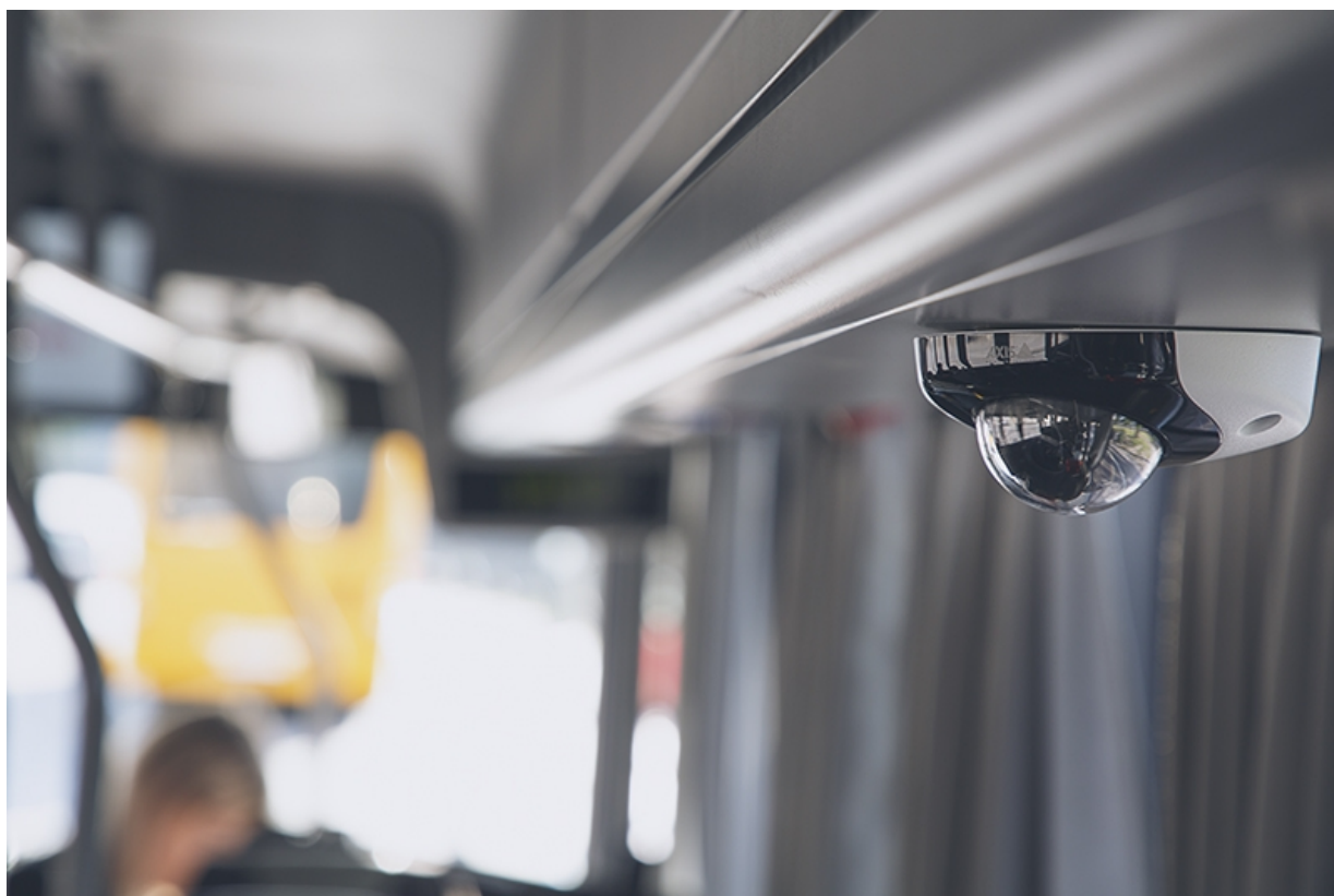
Una cámara con almacenamiento en el extremo en una instalación a bordo.
