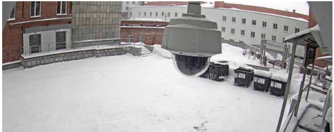
Abb. 6: Testkamera von Axis, installiert am Teststandort in Nowosibirsk.
