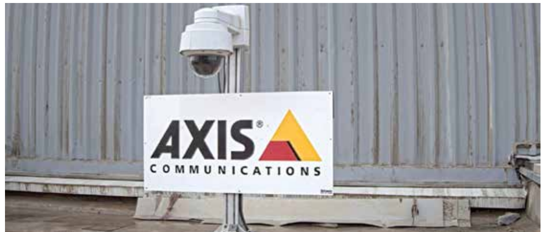
Abb. 7: Testkamera von Axis, installiert am Teststandort in Dubai.
