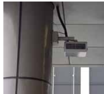
AXIS Q1755 2台は、PMCオリジナルのハウジングに収納され、駐車場入り口に向けて設置されています。
